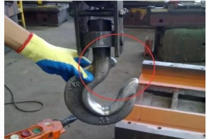
吊钩无防脱钩装置
