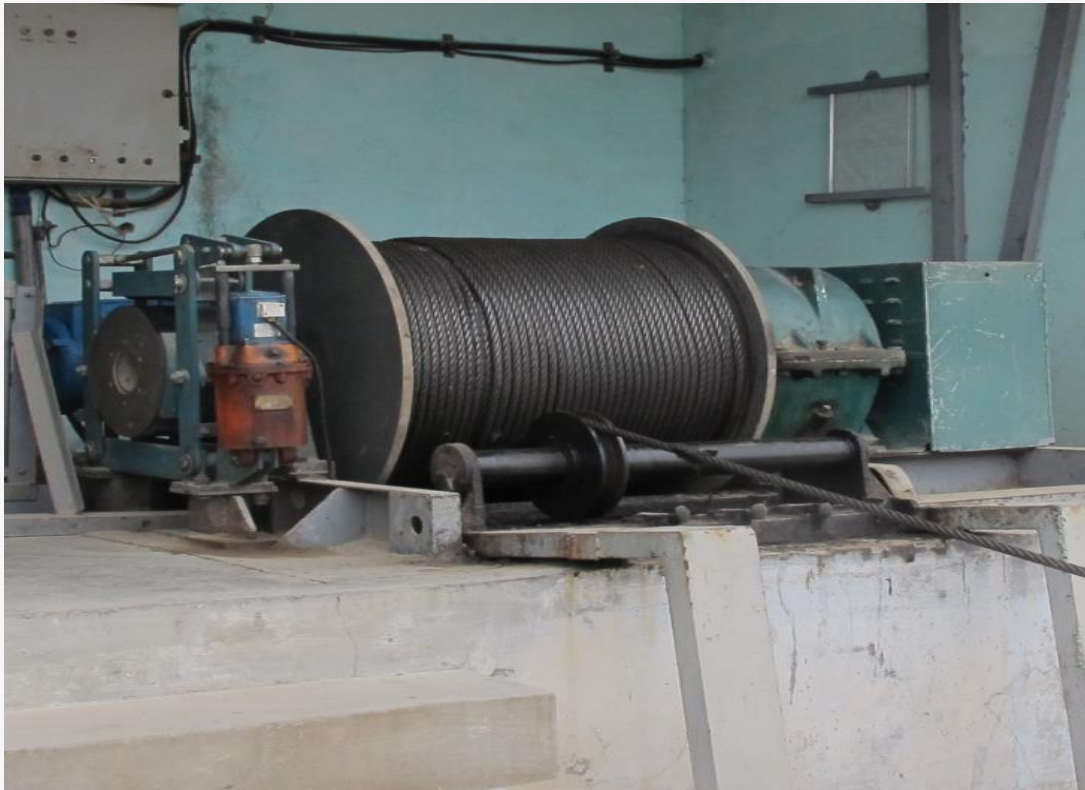
风险：拉紧的钢丝绳具有断裂伤人的风险
